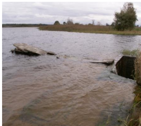
Повреждения водосбросных сооружений на вдхр. Лаздуны
