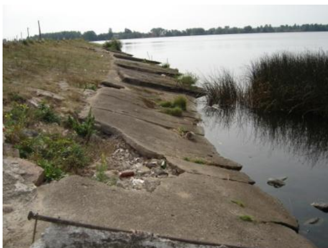
Разрушения плит креплений откоса на Чигиринском вдхр.
