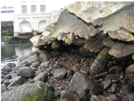
Повреждения в нижнем бьефе на вдхр. Волпа
